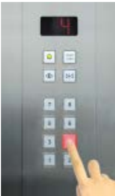
Aufzüge fahren in den Einrichtungen des Schwesternverbandes rauf und runter
